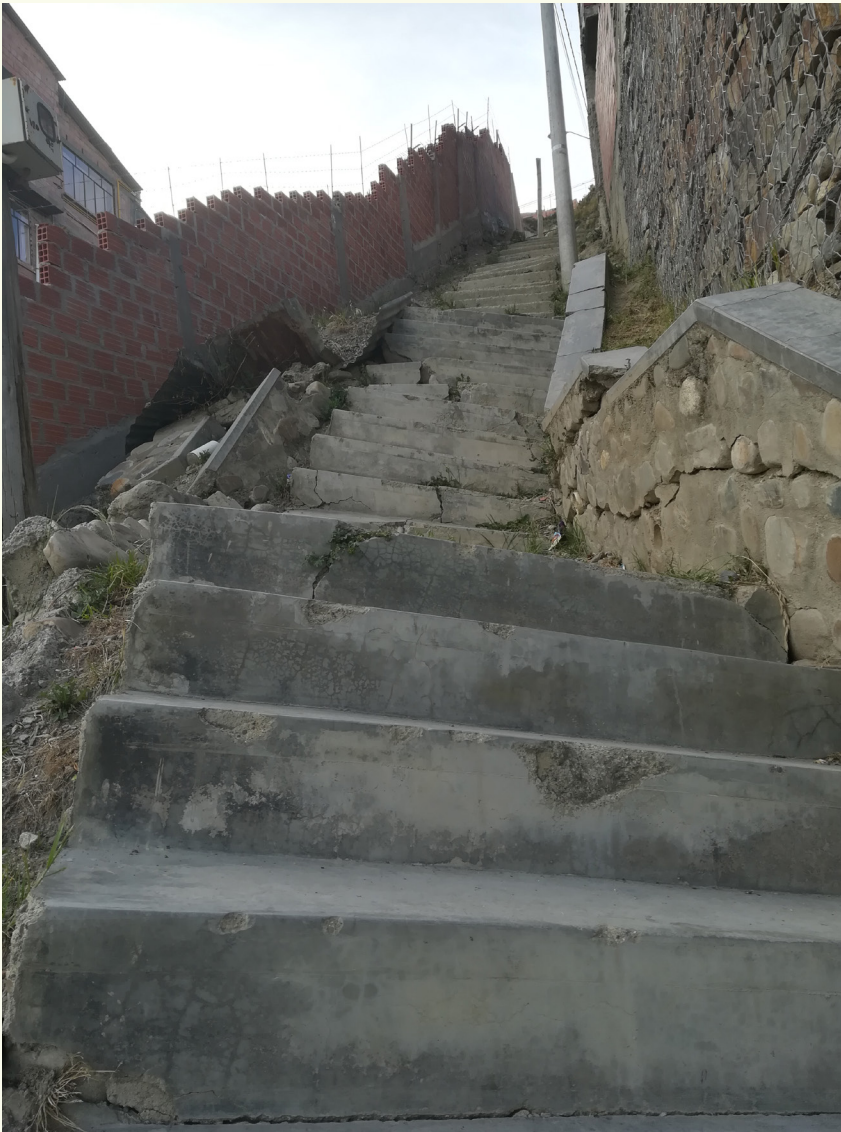
Figura 12. Inestabilidad de Llojeta. Foto: Gabriela Behoteguy, diciembre de 2018.
